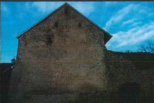
L'ancien rempart ne présente quasiment pas d'ouvertures, même lorsqu'il est a été intégré à une habitation.
