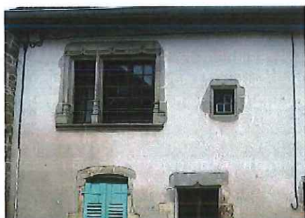
Les éléments techniques tels que fils électriques, boîtiers... méritent d'être dissimulés sous la toiture et peints de la couleur du fond de façade.
