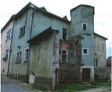
La réfection de la béance implique une réfection de l'enduit ou une extension adaptée au caractère ancien du bâtiment : mise en oeuvre de proportions, de volumes et de matériaux respectueux du bâti
