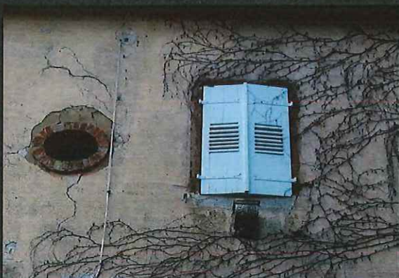
La réfection des enduits masquera les reprises disgracieuses réalisées en ciment apparent.
